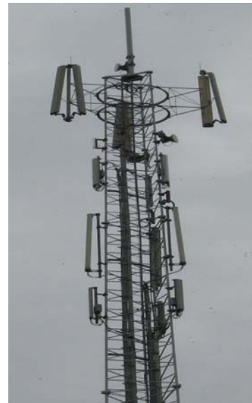
Het "digitale" asbest van Nu
